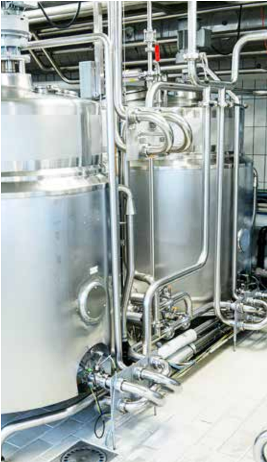
Im Zuge der Produktionsoptimierung hat Froneri bei der Füllstandsüberwachung der Mixtanks von Schwimmerschaltern auf Baumer Sensoren umgestellt.
